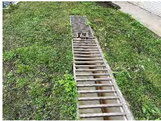
污水处理站排口
