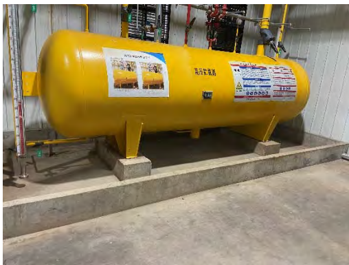
液氨储罐及围堰
