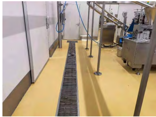
车间内废水管道
