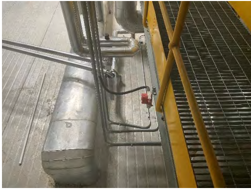
液氨泄漏报警装置
