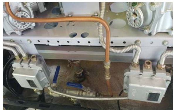
加油机二次油气回收系统
