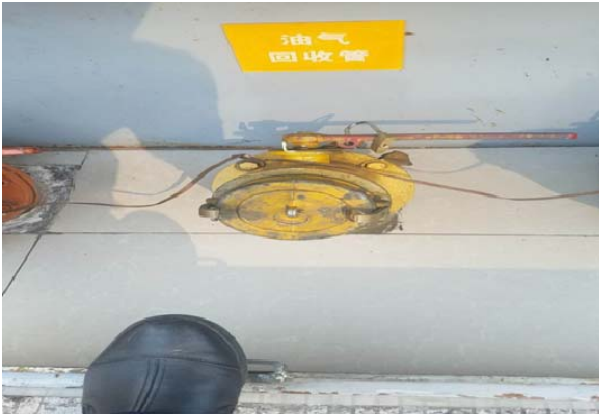
卸油口一次油气回收系统
