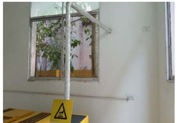
柴油发电机废气排气筒
