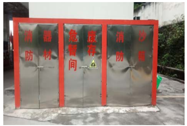
危废暂存箱及消防器材柜
