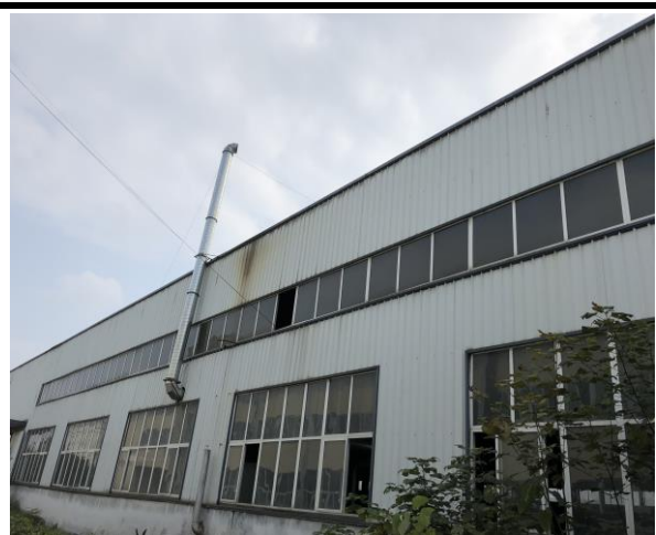
抛丸机废气排气筒
