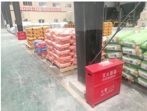
消防设施及成品区
