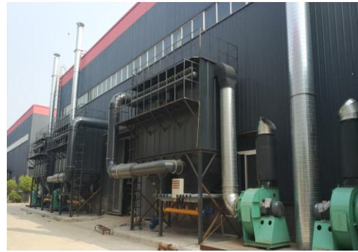
分装袋式静电脉冲除尘器及排气筒
