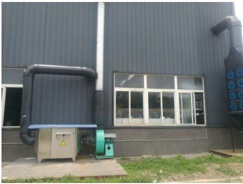
有机废气处理设施
